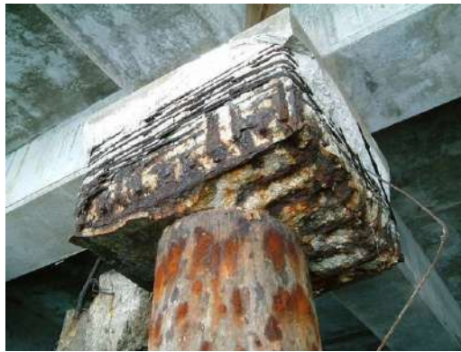
Рис. 5. Коррозия стальной арматуры
