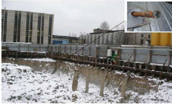
Рис. 1. Площадка строительства в Санкт-Петербурге. Вырванный анкер ограждения котлована
