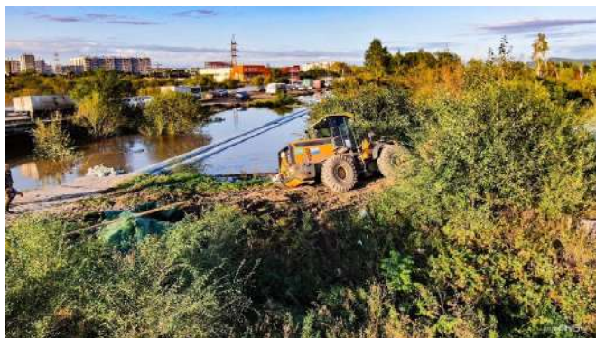
Рис. 5. Опрокидывание на рыхлом грунте
