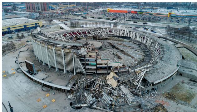
Рис. 1. Здание СКК «Петербургский» после обрушения крыши
