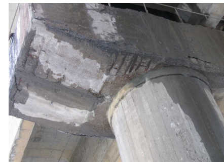
Рис. 6. Разрушение защитного слоя ригеля опоры 18 вследствие систематического увлажнения через деформационный шов
