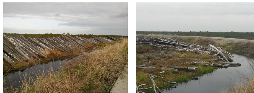
Рис. 2. Разрушения и деформации земляного полотна
