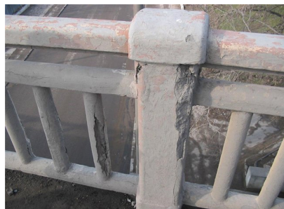
Рис. 2. Коррозионные повреждения перильных ограждений
