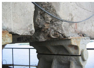
Рис. 4. Разрушение бетона на торце балки пролета 27–28 над опорой 28 вследствие систематических протечек воды через негерметичный деформационный шов
