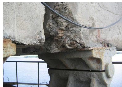
Рис. 4. Разрушение бетона на торце балки пролета 27–28 над опорой 28 вследствие систематических протечек воды через негерметичный деформационный шов
