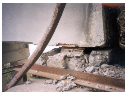
Рис. 5. Разрушение подферменника и опорной части на опоре 3 вследствие систематических протечек воды через негерметичный деформационный шов
