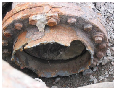
Рис. 3. Коррозия зоны опирания опоры освещения
