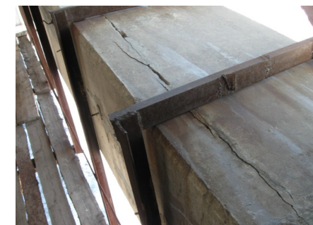
Рис. 8. Коррозионные трещины в элементе НП-5 фермы над опорой 10
