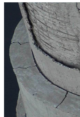
Рис. 7. Разрушение бетона защитного слоя в нижней части стойки опоры №6 вследствие систематического замачивания
