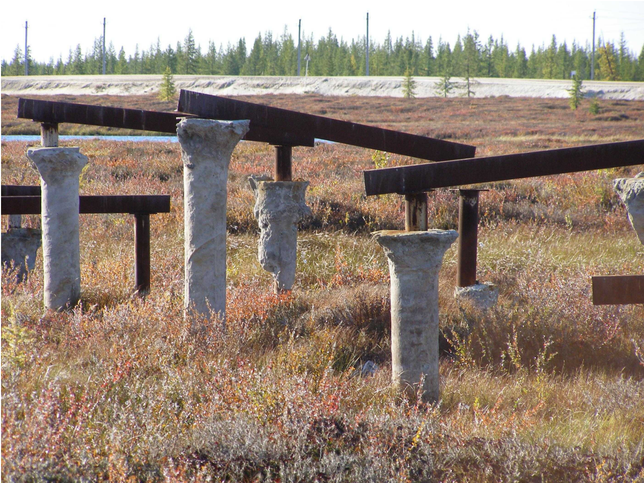
Рис. 3. Выпучивание свай опор трубопроводов
