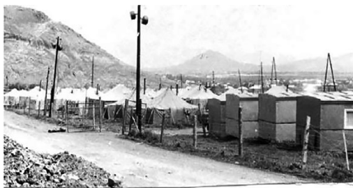
Рис. 4.7. Общий вид вахтового поселка строителей в п. Пушкино из палаток и контейнеров для строительных организаций, принявших участие в ликвидации последствий землетрясения в Армении
