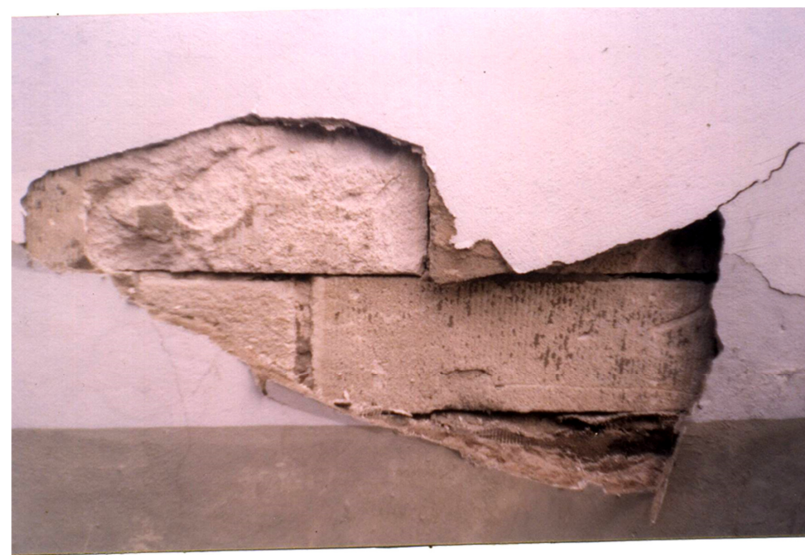
Рис. 2. Повреждение пенобетона под штукатуркой
