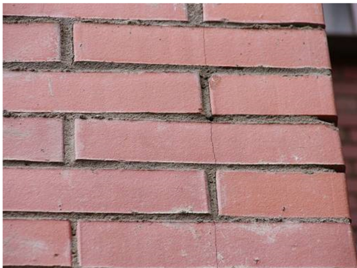
Рис. 5. «Свежая трещина» в облицовке вблизи выступающего угла стены
