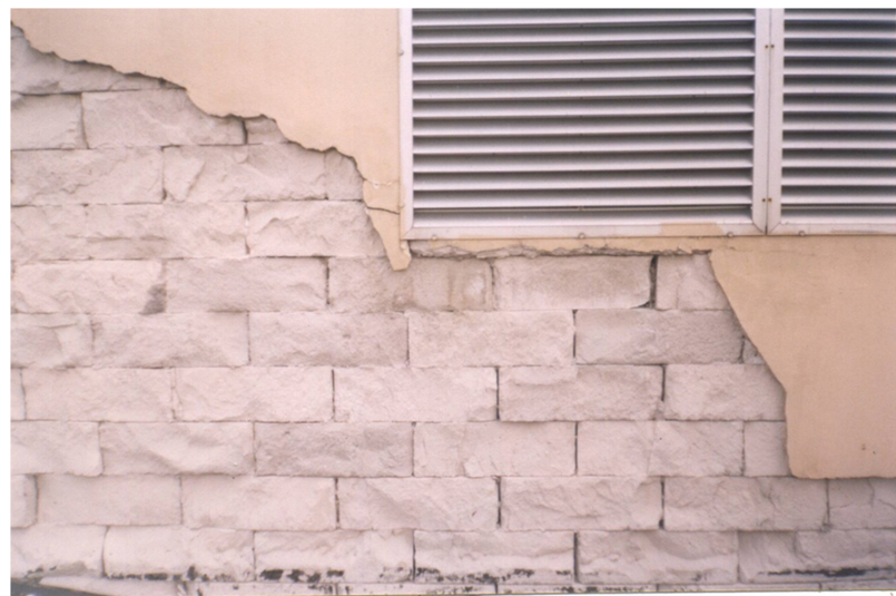
Рис. 1. Разрушение штукатурки и наружного слоя газобетона на здании торгового центра
