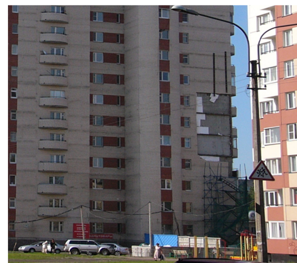
Рис. 4. Обрушение ограждающих конструкций жилого дома
