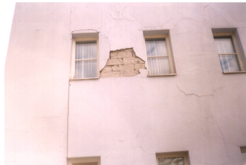
Рис. 3. Повреждение стен банно-прачечного комбината
